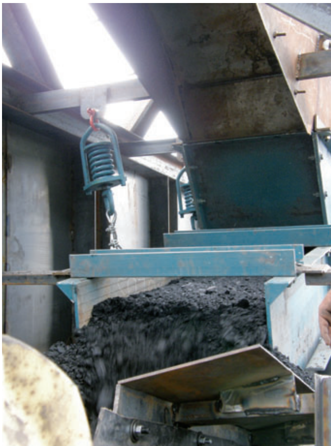
Equipamiento adicional para racionalizar el proceso de alimentación de material
